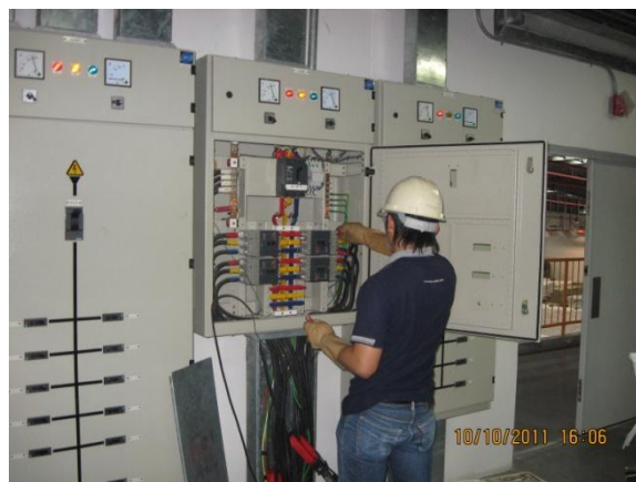
รูปที่ 4.6 การตรวจวัดค่าทางไฟฟ้าที่ตู้ MDB
