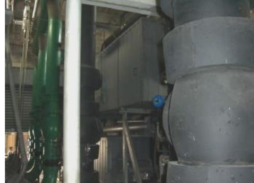
รูปที่ 6.29 Absorbtion Chiller
