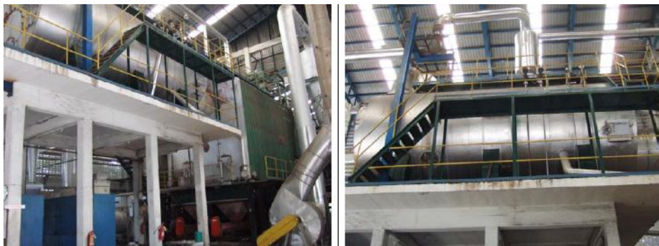
รูปที่ 6.75 หม้อไอน้ำเชื้อเพลิงชีวมวลขนาด 20 ตันไอน้ำ/ชั่วโมง
