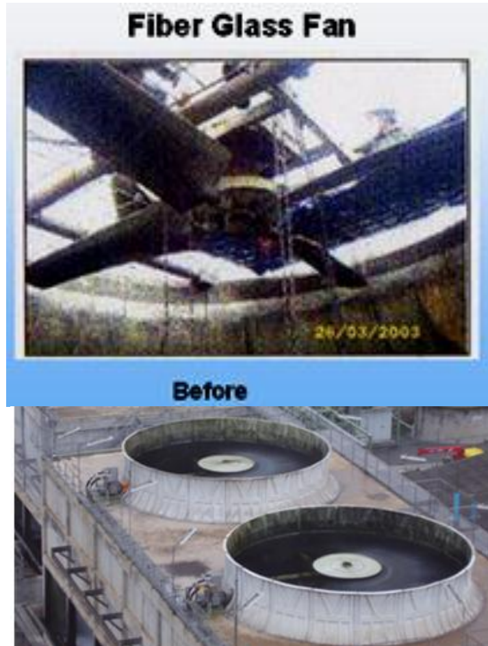
รูปที่ 6.50 ใบพัด cooling Tower (ก่อนดำเนินการปรับปรุง)
