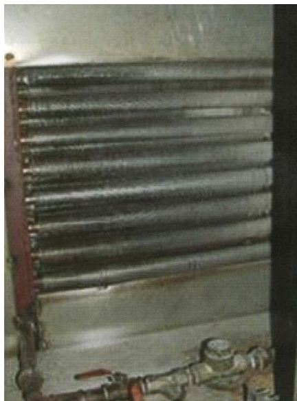
รูปที่ 6.7 คอยล์ร้อนของเตาอบแห้งผลไม้หลังดำเนินการปรับปรุง
