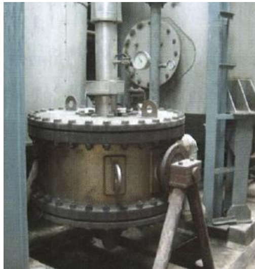
รูปที่ 6.9 เครื่องแลกเปลี่ยนความร้อนสำหรับการอุ่นน้ำมันพืชบริเวณถังเก็บน้ำมันพืช
