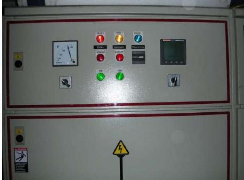
รูปที่ 6.18 ตู้ควบคุมระบบไฟฟ้า
