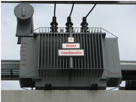
รูปที่ 4.4 หม้อแปลงไฟฟ้า
