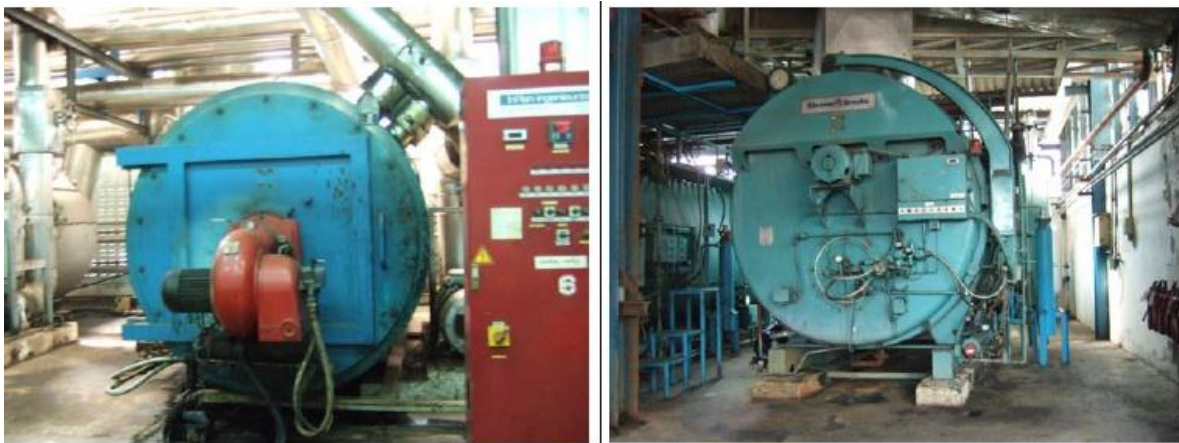
รูปที่ 6.72 หม้อไอน้ำและหม้อน้ำร้อนเดิม (ปัจจุบันติดตั้งเป็นเครื่องเดินสำรอง)
