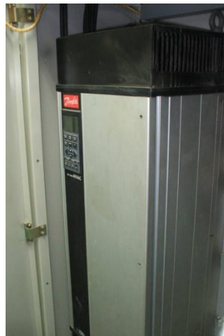
รูปที่ 6.58 การติดตั้ง VSD ของทางโรงงาน
