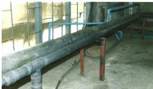
รูปที่ 6.54 ท่อสารทำความเย็นที่ดัดแปลงให้สามารถใช้ น้ำควบแน่นจากคอยล์เย็นช่วยระบายความร้อนได้
