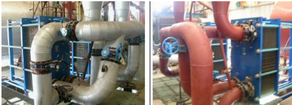
รูปที่ 6.23 Plate heat exchanger ที่ติดตั้งหลังปรับปรุง
