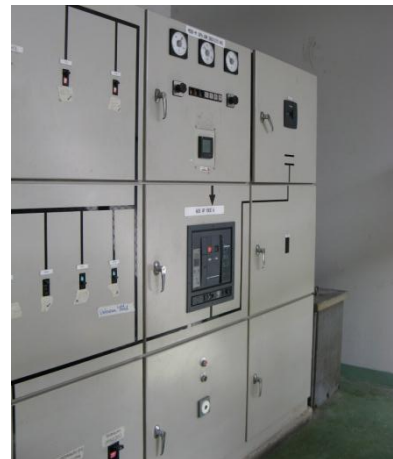
รูปที่ 4.5 ตู้ส่งจ่ายไฟฟ้า (ตู้ MDB)
