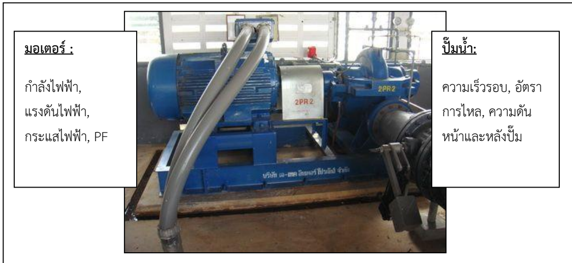
รูปที่ 4.11 ตำแหน่งการตรวจวัดระบบปั๊มน้ำ
