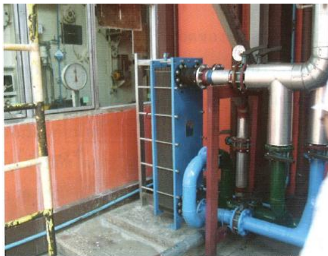
รูปที่ 6.3 เครื่องแลกเปลี่ยนความร้อนแบบแผ่นที่ติดตั้งใหม่
