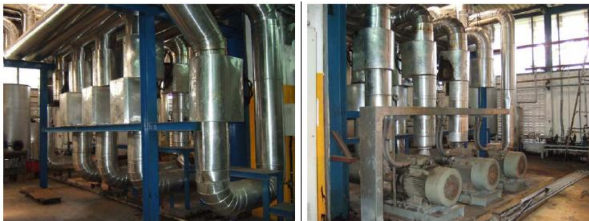
รูปที่ 6.77 (ซ้าย) ระบบส่งไอน้ำเข้าโรงงาน (ขวา) ระบบส่งน้ำมันร้อนเข้าโรงงาน
